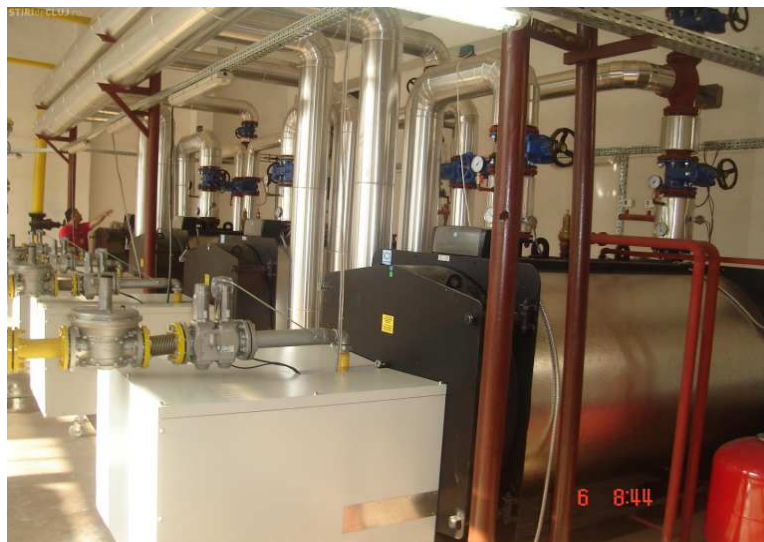
Centrală Termică de cvartal modernizată
