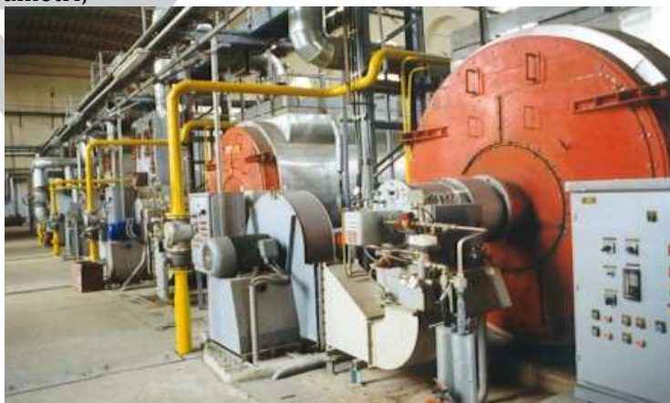
CTZ Casa Presei Libere – Sala cazanelor
