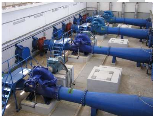
Uzina de pompare a stației Crivina
